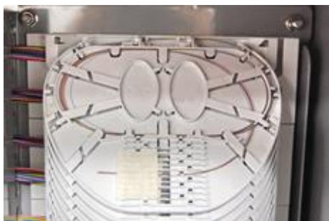
Figura 19: SISTEMAZIONE DELLE FIBRE OTTICHE NEI MODULI DI GIUNZIONE
